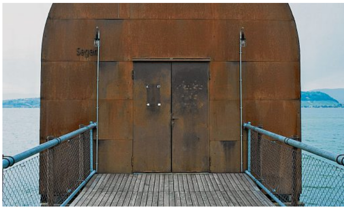
Die Cabane in Muntelier muss saniert werden. Bild Charles Ellena/za
