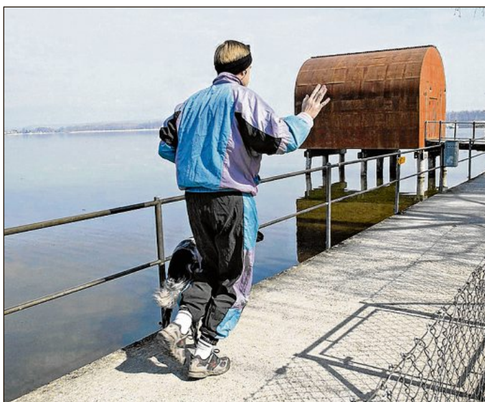
Propriété de la commune, le pavillon lacustre nécessite notamment le remplacement de sa structure porteuse. CHARLES ELLENA - A
