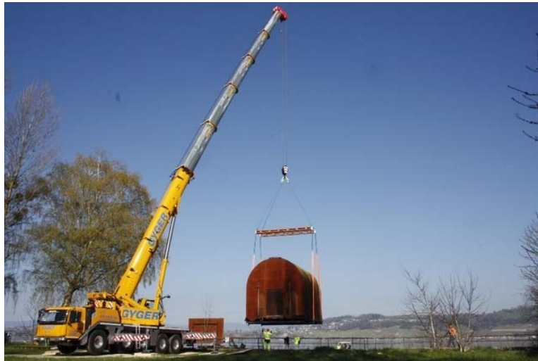
Luftreise: Die Cabane von Muntelier wird temporär versetzt, damit die Pfähle ersetzt werden können. Bild: Etelka Müller
