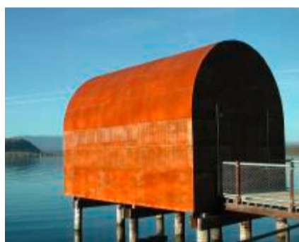
La Cabane soll saniert und einem neuen Zweck zugeführt werden. Laura Fehlmann
