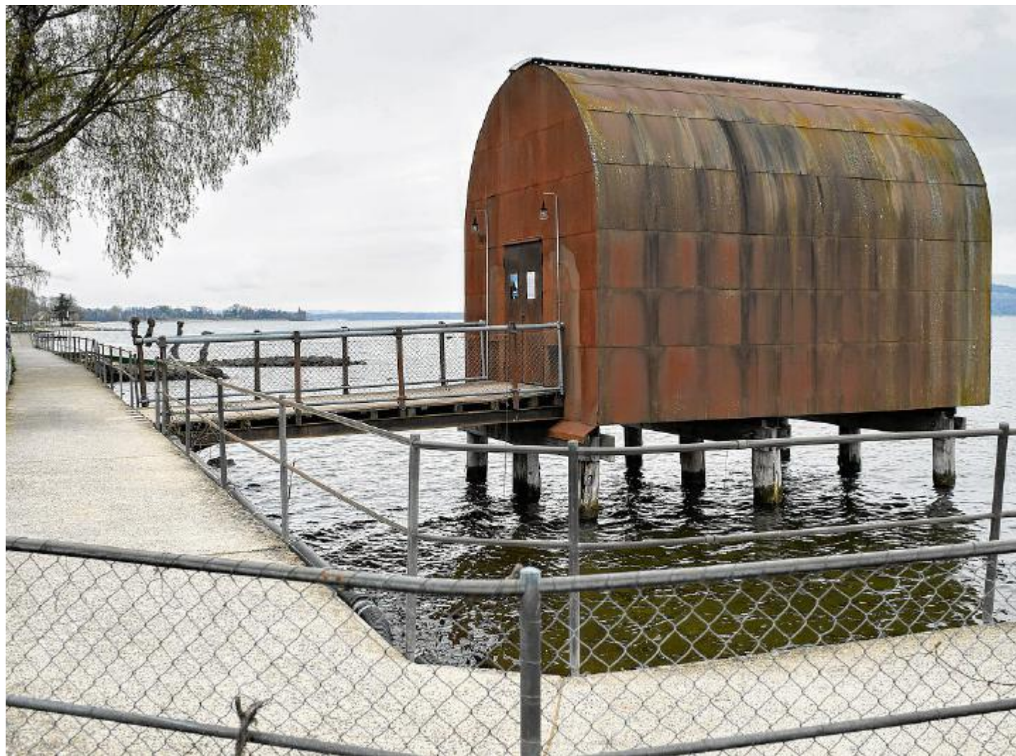
An den Pfählen der Cabane nagen die Zähne der Zeit und des Sees.
