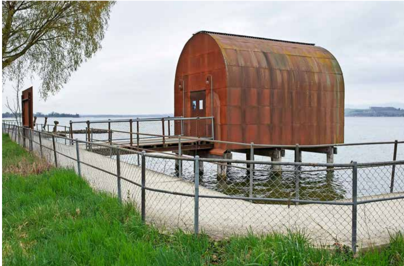
Die Sanierung der Cabane in Muntelier wird rund 150 000 Franken kosten. 30 000 Franken bezahlt die Gemeinde.
